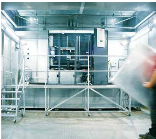
Dimensioni interne della camera climatica: Altezza 4180 mm, larghezza 9760 mm, profondità 5680 mm
