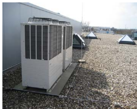
Auf dem Dach montiertes Außengerät
