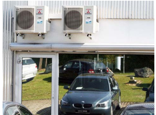
Installierte Außengeräte über Eingang.
