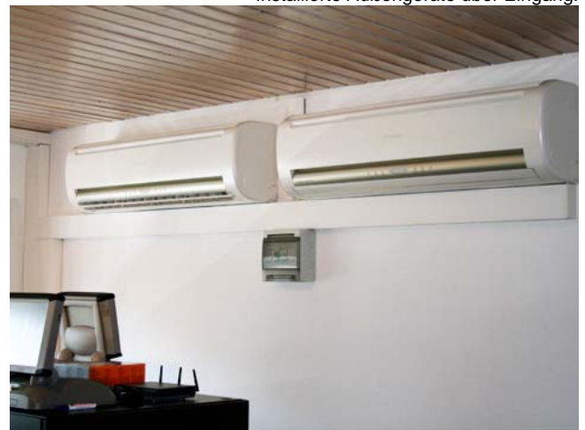
Installierte Wandgeräte im Serverraum – darunter Elektronik-Modul
