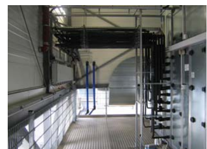
Kältemittelleitungen zu den Expansionsventil-Kits
