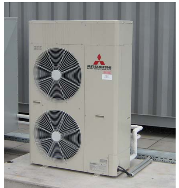
frei installiertes Außengerät
