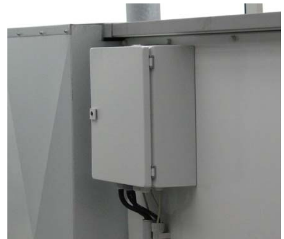
Schaltschrank für Platinen des Steuerungs-Kits
