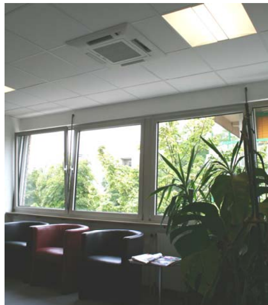
Deckengerät im Warteraum
