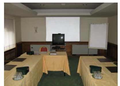
Den Schulungsraum wird über Truheneinbaugeräte klimatisiert
