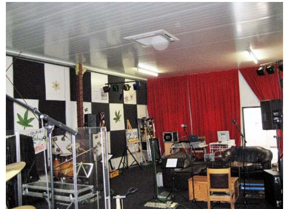
Installierte Deckenkassette im Proberaum
