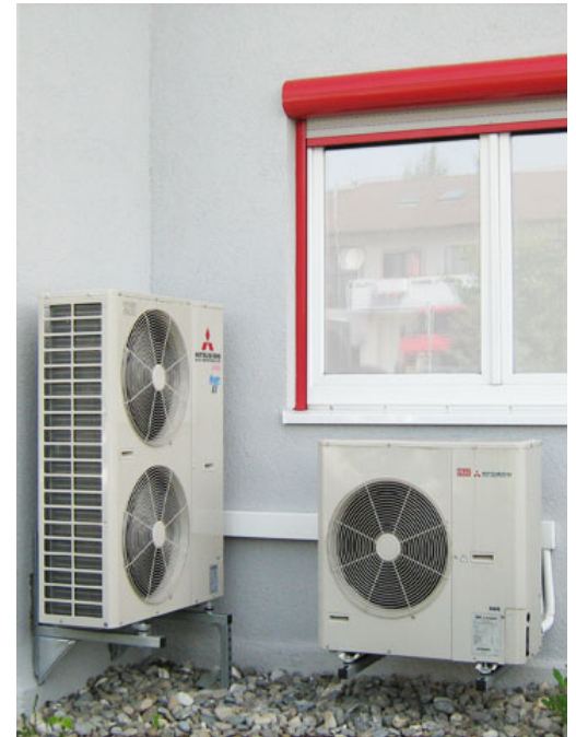
Außengeräte an der Gebäudefassade
